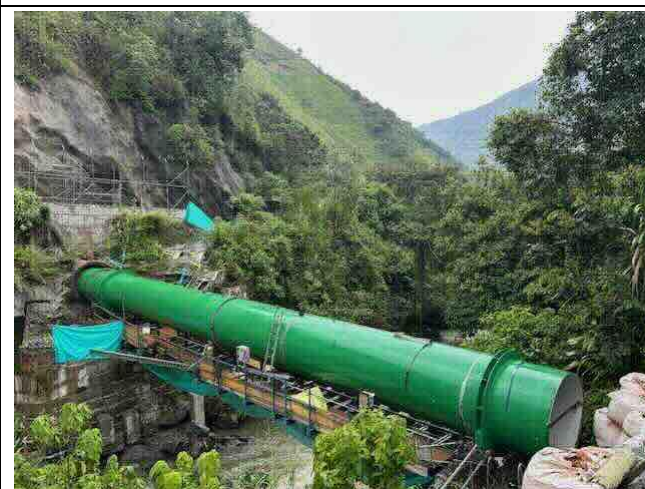
Foto 18: tubería de presión de la PCH Chorreritas cruzando el río San Andrés
